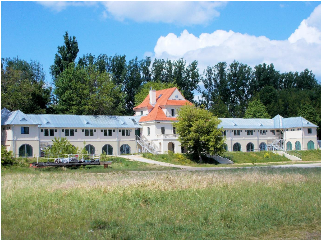
Odnowiony budynek Łazienek Rzecznych stanowi część zespołu kąpieliska nad Wartą, na Łęgach Dębińskich, fot. Małgorzata Mazurek
